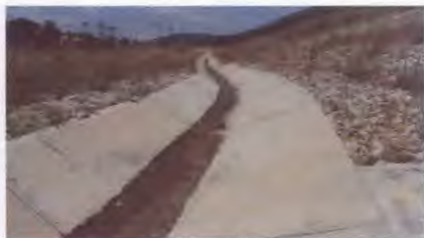
ระดับ 5 สภาพดี/น้ำไหลปกติ
