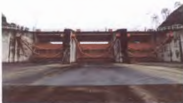
บานระบาย (รวมอุปกรณ์อื่น) เขื่อนแม่จัดสมบูรณ์ชล จังหวัดเชียงใหม่
