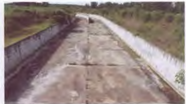
รางเท (Chute) เขื่อนกัวคองมา จังหวัดระยอง
