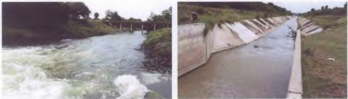
ภาพที่ 31 ส่วนคลองส่งน้ำ/ระบายน้ำ อาคารท่อน้ำ/อาคารท่อระบายน้ำ
