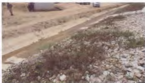
ระดับ 2 เกิดการซึมและมีการไหลรวม
