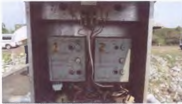
ระดับ 1 เกิดการเสื่อมสภาพใช้งานไม่ได้
