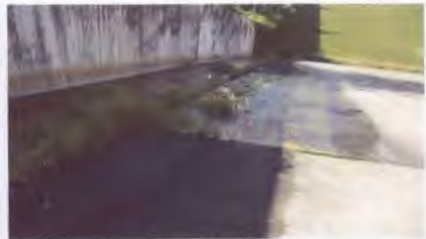
ระดับ 3 เกิดการรั่วและมีน้ำไหลซึม
