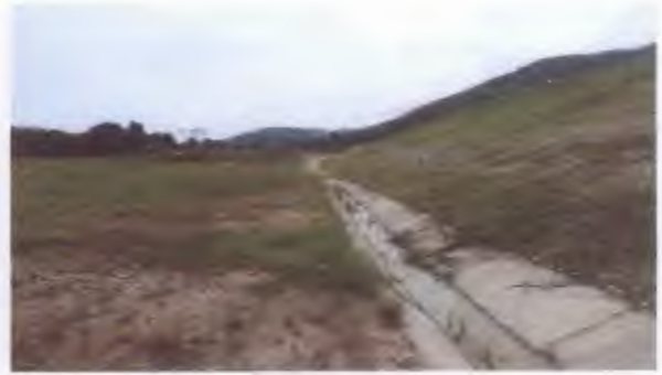
Open Drain เขื่อนบางเหนียวดำ จังหวัดภูเก็ต
