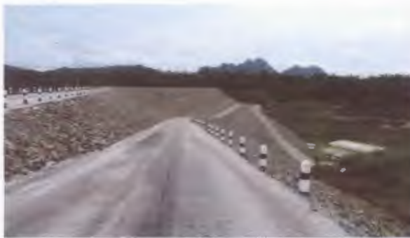
ลาดเขื่อนท้ายน้ำ เขื่อนก๊วกอหมา จังหวัดลำปาง
