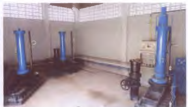
Guard and Operating Gates เขื่อนคอยงู จังหวัดเชียงราย
