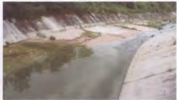
คลองระบายน้ำ คลองคอนกรีต เขื่อนหนองปลาไหล จังหวัดระยอง
