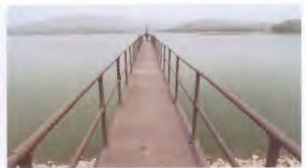
สะพาน (Access Bridge) เขื่อนป่าแดง จังหวัดเพชรบูรณ์
