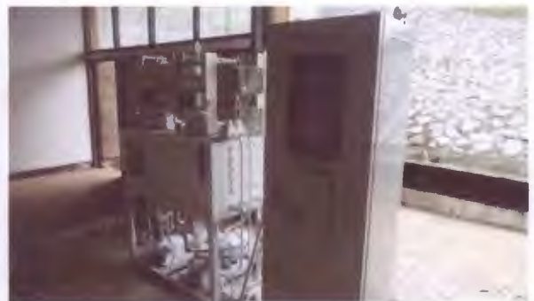
อุปกรณ์เครื่องกล และอุปกรณ์ไฟฟ้า เขื่อนแม่งัดสมบูรณ์ชล จังหวัดเชียงใหม่
