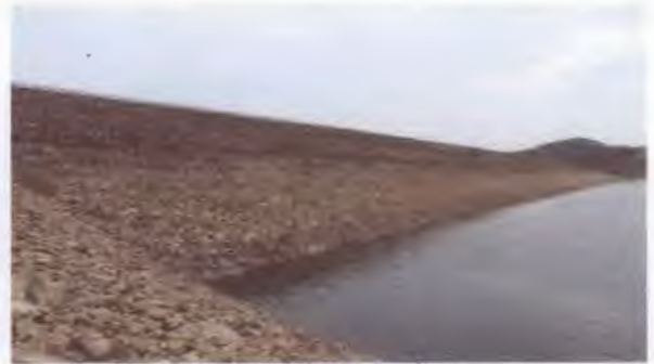
ลาดเขื่อนเหนือน้ำ เขื่อนแม่กวงอุดมธารา จังหวัดเชียงใหม่
