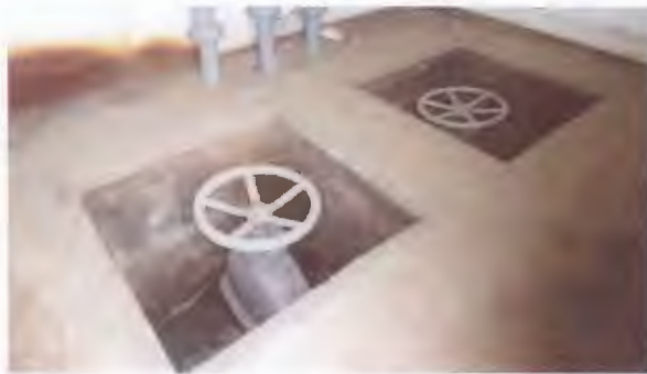
Guard and Operating Valves เขื่อนแม่จอกหลวง จังหวัดเชียงใหม่
