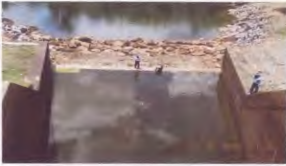
ส่วนสลายพลังงาน เขื่อนแก่งกระจาน จังหวัดเพชรบุรี
