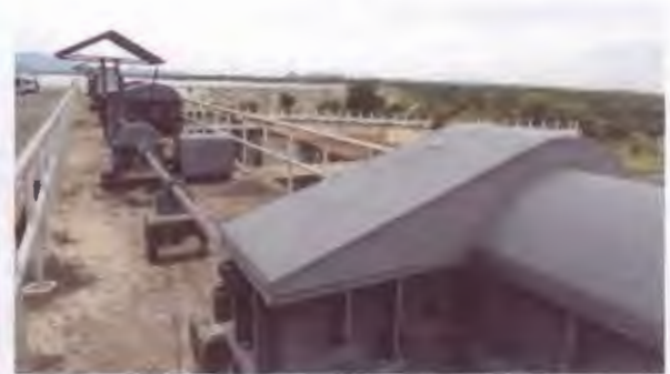
บานระบาย (รวมอุปกรณ์อื่น) เขื่อนห้วยเสลา จังหวัดอุทัยธานี
