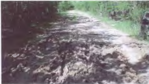
ระดับ 1 เกิดร่องล้อ/ผิวจราจรสูญเสยกำลัง
