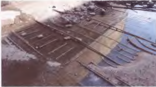
ระดับ 1 กัดกร่อนเห็นเนื้อเหล็ก
