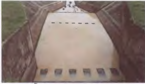
พื้น (รวมพื้นตะเข้) และกำแพง เขื่อนห้วยหลวง จังหวัดอุดรธานี
