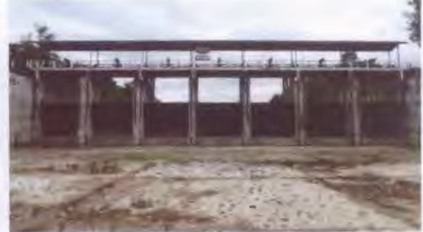
บานระบาย (รวมอุปกรณ์อื่น) เขื่อนลำตะคอง จังหวัดนครราชสีมา
