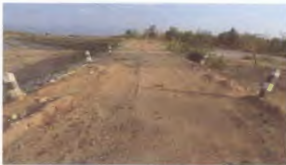
เขื่อนแม่หวาน จังหวัดลำปาง ไม่มี Rockfill Toe
