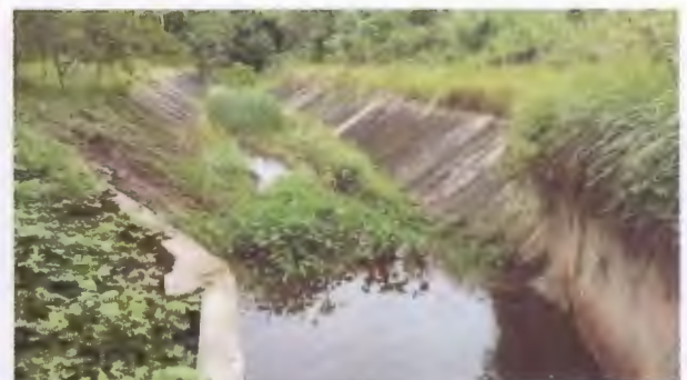
ระดับ 3 มีสิ่งกีดขวางทางน้ำ แต่ปิดขวางทางเดินน้ำบางส่วน
