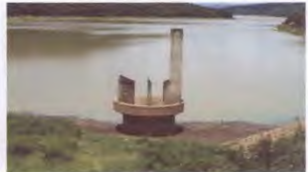
ฝาย คลیبและท่อตั้ง เขื่อนลำพระเพลิง จังหวัดนครราชสีมา
