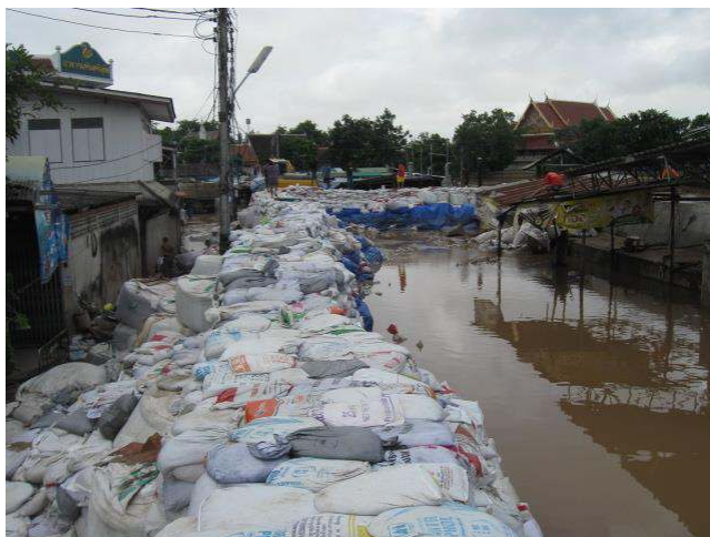
รูปที่ 8-1 แสดงแนวคันกันน้ำที่ดำเนินการแล้วเสร็จ เมื่อระดับน้ำด้านในคันมีระดับใกล้เคียงกับในแม่น้ำยม สามารถลดความแรงของกระแสน้ำได้อย่างเห็นได้ชัด
