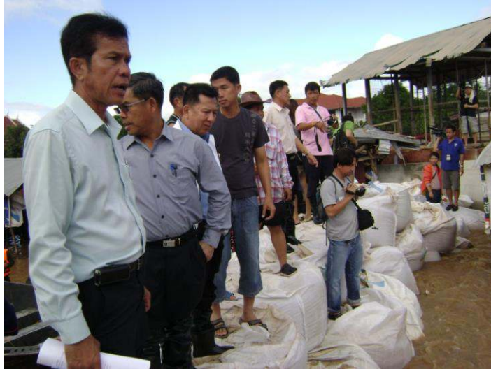
รูปที่ 6-4 แสดงแนวถุงทรายขนาดใหญ่ที่เทศบาลเมืองสุโขทัยธานีทำไว้แต่ไม่สามารถด้านกระแสน้ำได้
